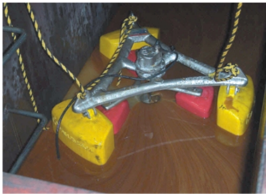
設置於集中冷卻槽
